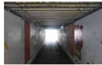
Dunkle Beleuchtung in zu schmaler und zu niedriger Unterführung
