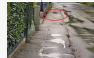
zu schmaler Gehweg mit Bauschäden und Stolperschwellen, der unvermittelt endet
